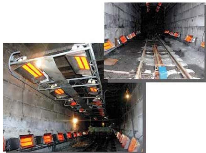
Рисунок 5 – Общий вид установки с газовыми инфракрасными излучателями
